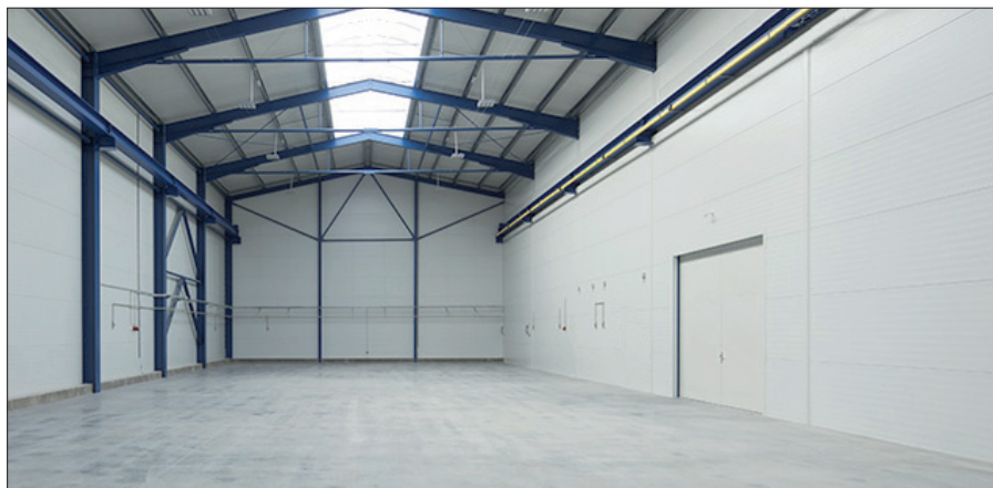
Obr. 1. Průmyslová hala osvětlená světlíkem zaskleným rozptylným materiálem; přímé sluneční světlo je rozptýleno a významně se podílí na osvětlení haly
